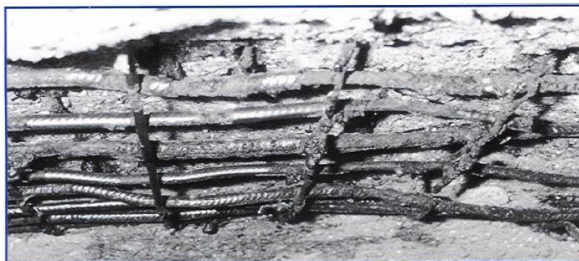
Slika 1: Poškodbe armiranobetonskega elementa med požarom
